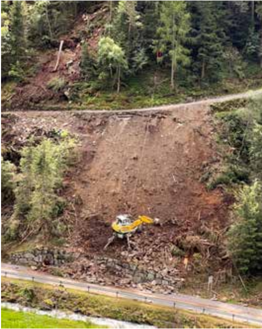
Komplett abgerutscht: Pluiroanweg Niederthai
