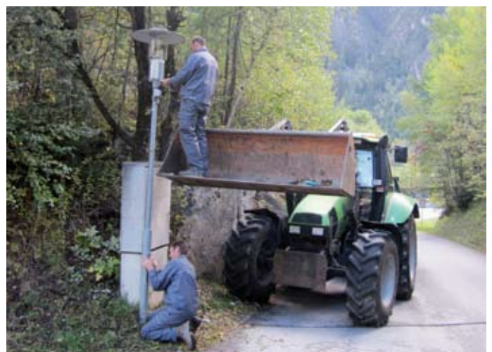
Aus Gründen der Stromersparnis wurde die veraltete Lampentechnologie der Straßenbeleuchtung durch neue LED Lampen ersetzt.
